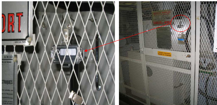
Figure 1 – Dosimètre d'ambiance placé au niveau d'un grillage de protection de l'émetteur du radar Palmier .
