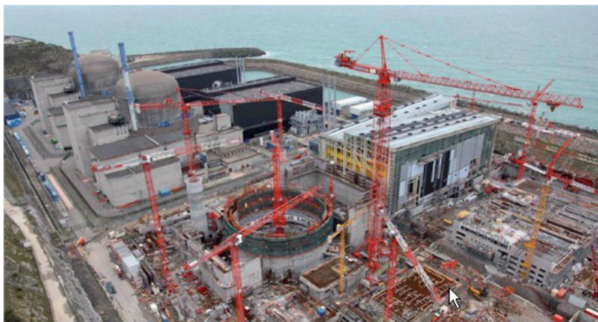
Figure 2 – Chantier de l'EPR français de Flamanville (décembre 2009). Flamanville construction site of the first French EPR (December 2009).
