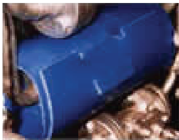
Figure 19 – GAMMASTOP ® appliqué sur un tuyau. GAMMASTOP ® applied to a pipe.
